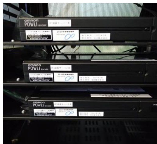
遠方監視装置（監視塔機器） ②
