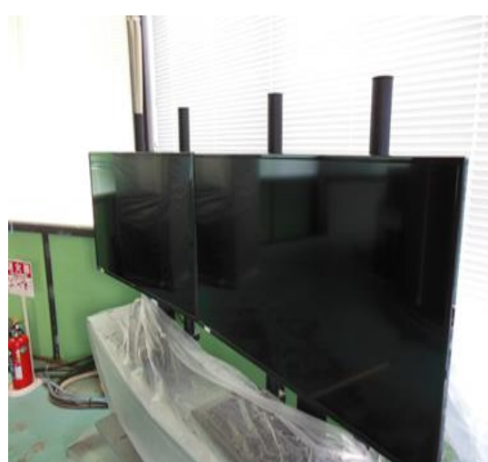
遠方監視装置（監視塔機器） ④
