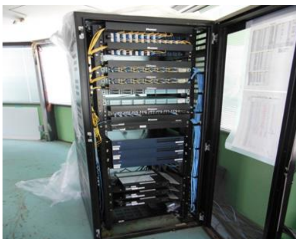
遠方監視装置（監視塔機器） ①
